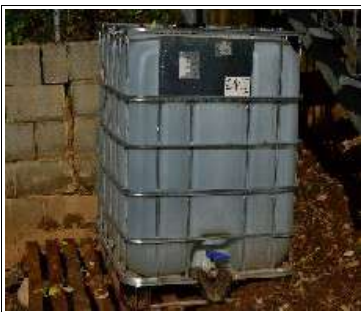
Fig.10: Dipòsit d'aigües pluvials
