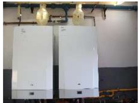
Fig.14: Caldera de condensació
